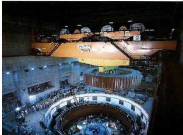
Ponte Rolante 1000t - Hidroelétrica ITAPU.
